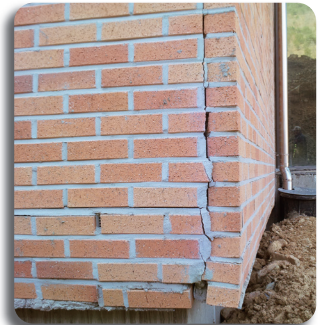
- 모서리 부분 수직균열 -
