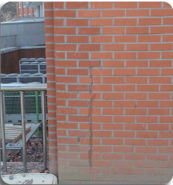
- 모서리 부분 수직균열 -
